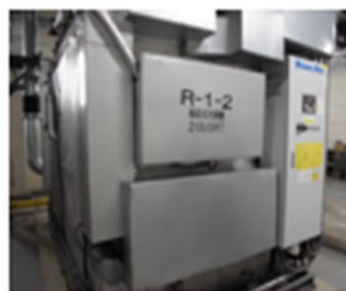
吸収式冷凍機 COP1.2 冷却能力739kW/台 ガス消費量 53.5Nm 3 /h
