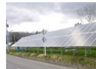
柵塀の設置されない設備
