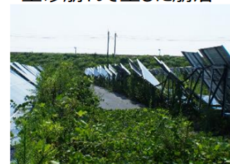
放置されたパネルの現況
