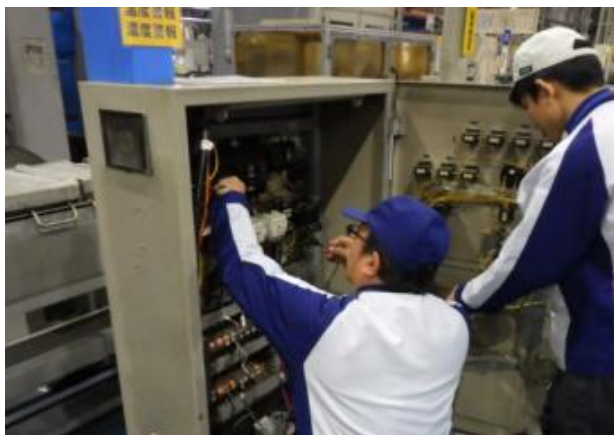
電力量計の取付
