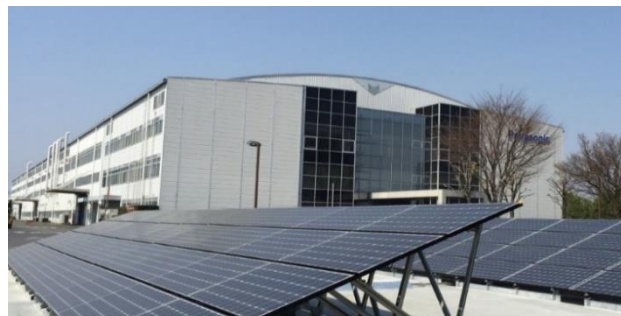
太陽光発電設備 19.2KW
