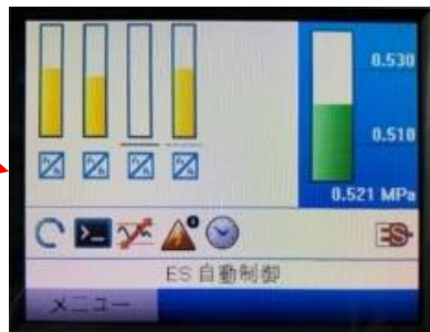
各号機の運転状況と圧力表示
