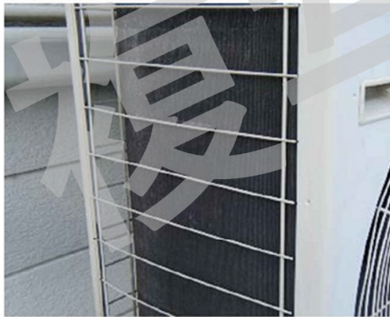
写真 室外機 外観 ※類似事例 20%詰まりで軸動力10%増加
