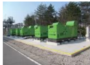
(消化ガス発電設備)
