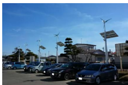
宮城県東松島市の指定避難所における太陽光パネルと風力発電
