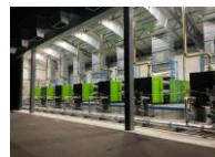
(バイオガス発電設備)
