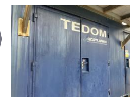
(発電所内の発電機)
