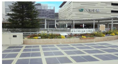
（八王子駅前の路面に設置した当社製品）
