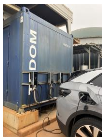
(電気自動車充電設備)
