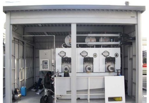
米のとぎ汁濃縮装置
