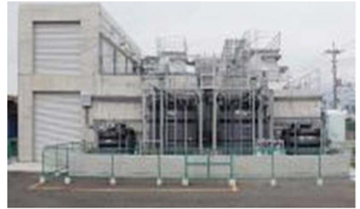
半導体工場排水設備
