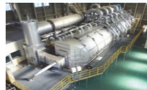
アンモニア燃焼試験設備 (4t/h燃焼試験炉)
