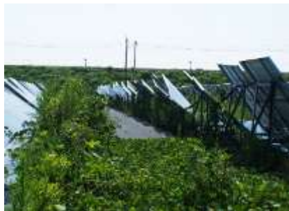
不十分な管理で放置されたパネル
