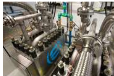
水素製造装置
