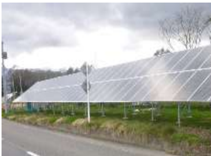
柵塀の設置されない設備
