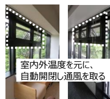
自動制御自然換気窓
